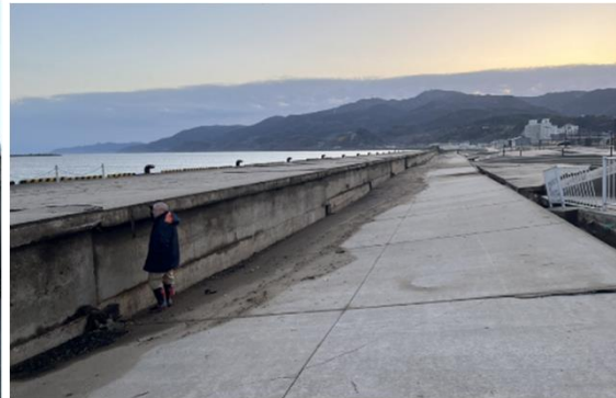
輪島港の被災（輪島市）
