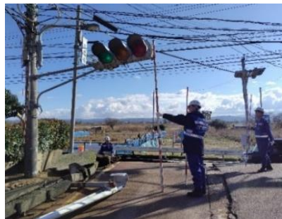
道路の被災状況調査 (石川県内灘町)
