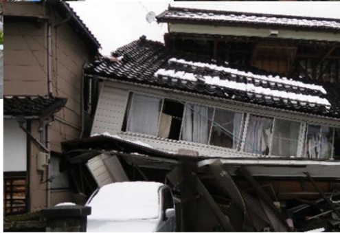
木造建築物の倒壊状況（穴水町）
