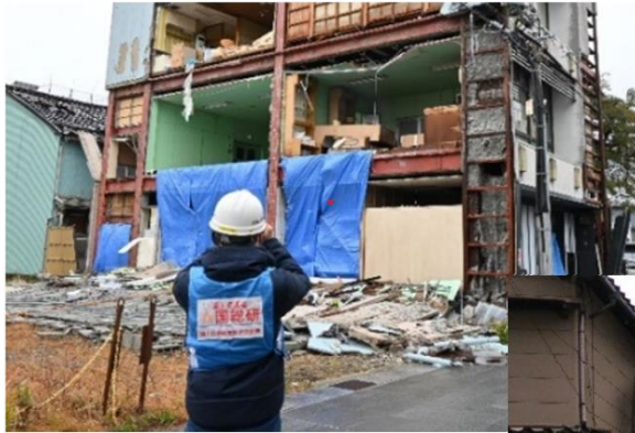
建築物の損壊状況（七尾市）
