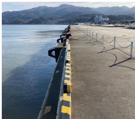
岸壁本体の被災状況
