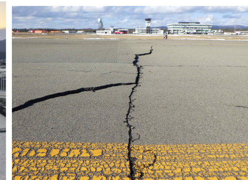
能登空港の被災（穴水町）
