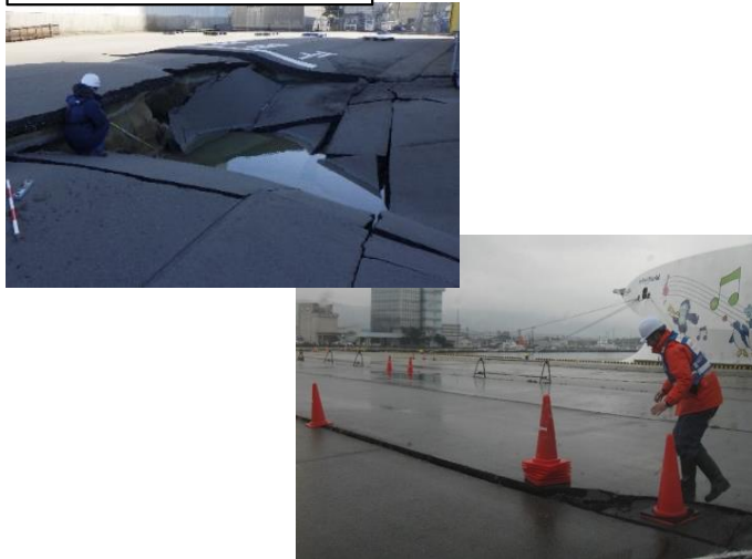
岸壁背後の被災状況
