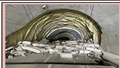
写真① 国道249号大谷トンネル内の崩落
