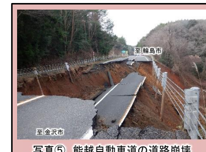
写真⑤ 能越自動車道の道路崩壊
