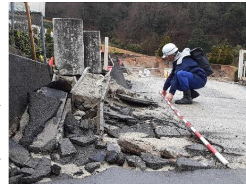
岩屋浄水場の被災（七尾市）
