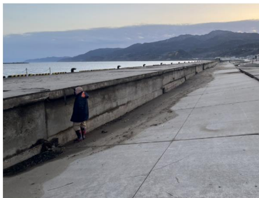
岸壁背後の被災状況
