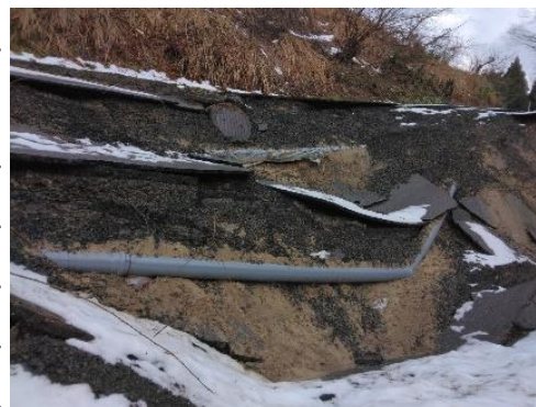
浄水場から配水池へ向かう水道管の破損・露出（輪島市）
