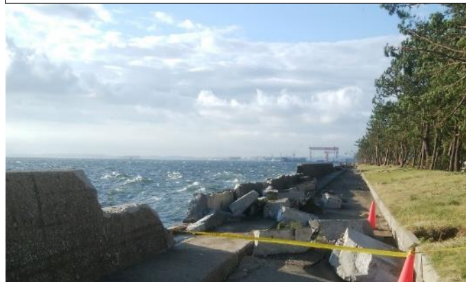
護岸の損傷（横浜港）
