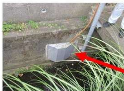
水位センサー設置（例）
